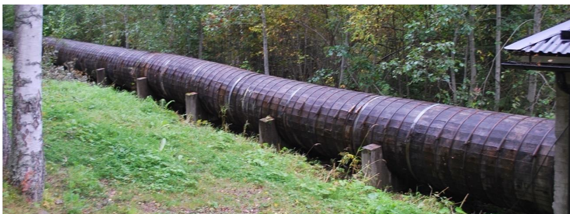
Trätuben som för Tunsjönåns (Bruksån) vatten ned till kraftverket.
