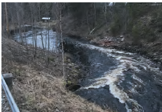
Vägtrumman nedströms vid kvarndammen.
