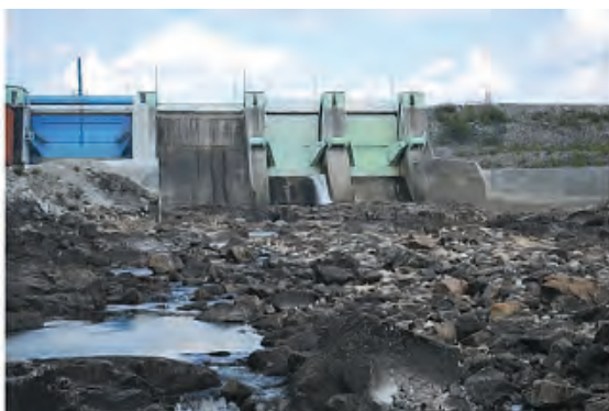
Timmerutskovet har ersatts med en dammlucka.
