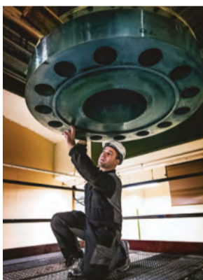
Generatorexperten Mats Berg från Älvkarleby synas nederdelen av generatoraxeln till det aggregat som ska repareras.
